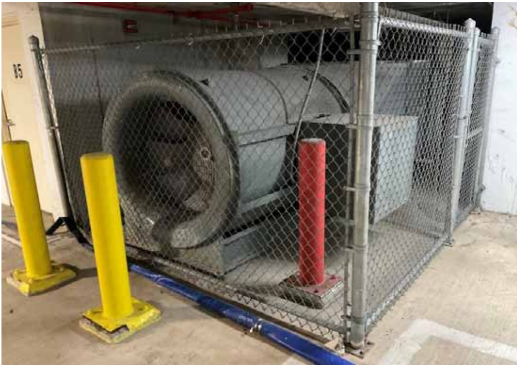
Garage Exhaust Fan
