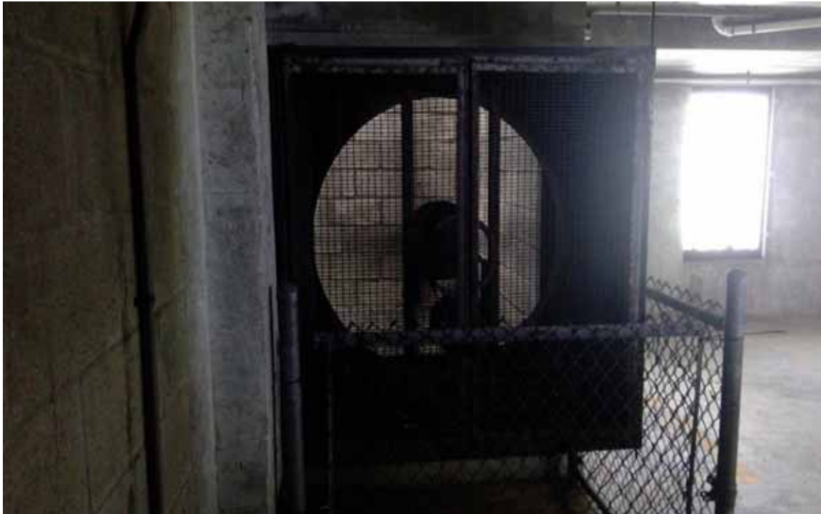
Garage Exhaust Fan
