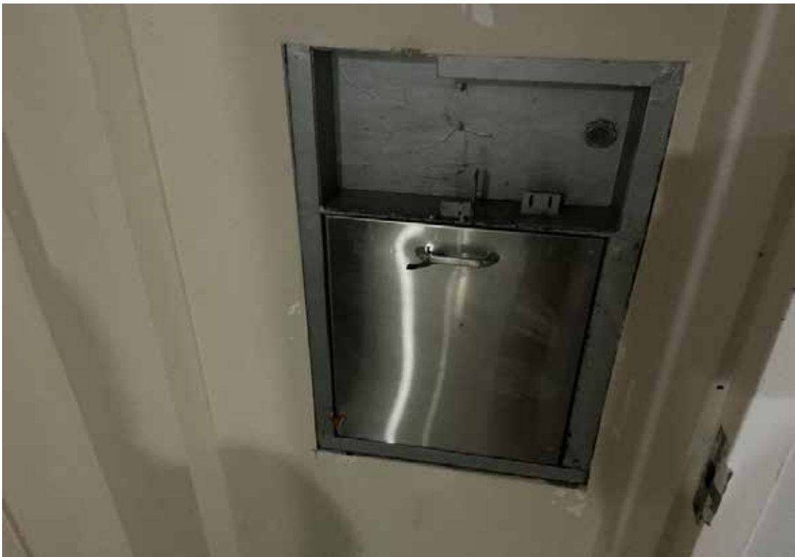
Trash Chute Door
