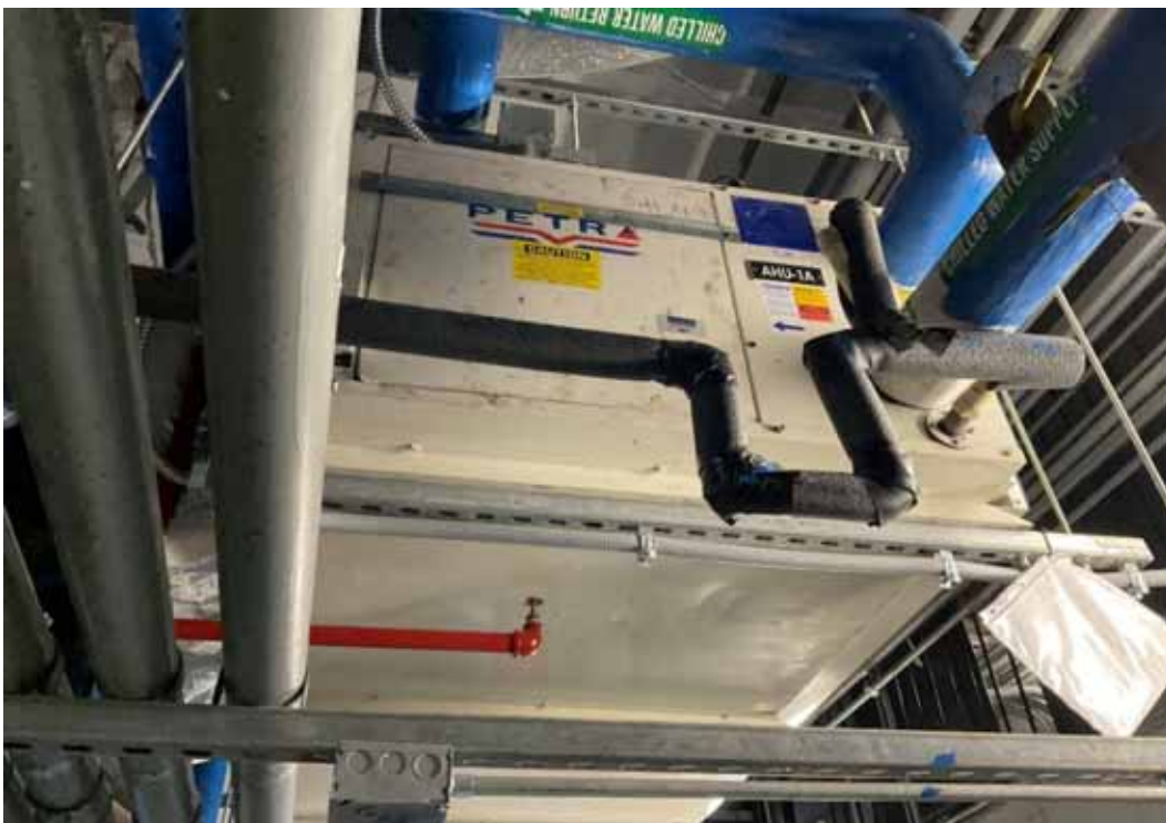
A/C - AHU - 1A
